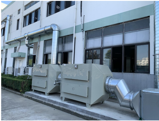
废气处理装置
