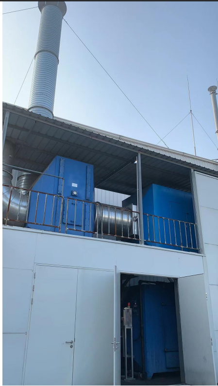
两级活性炭吸附装置及 DA003 排气筒
