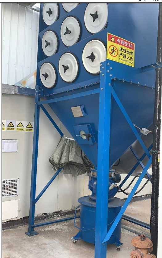
4#脉冲滤筒式除尘器
