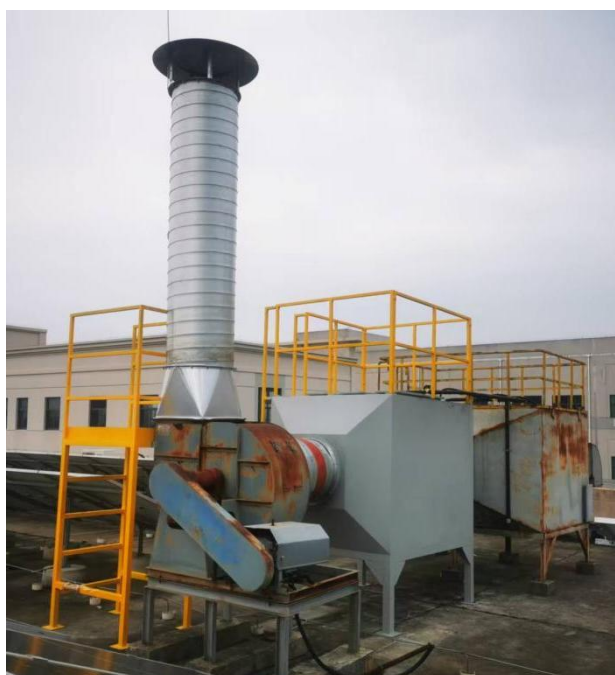
图 3-1 废气治理设施及排气筒
