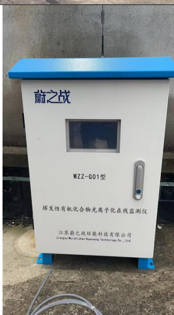
废气处理设施
