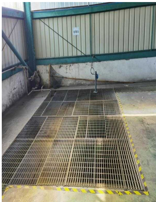
泄漏收集系统
