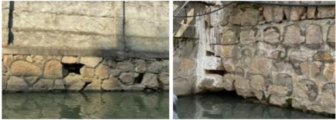
图 3-2 块石挡墙现状
