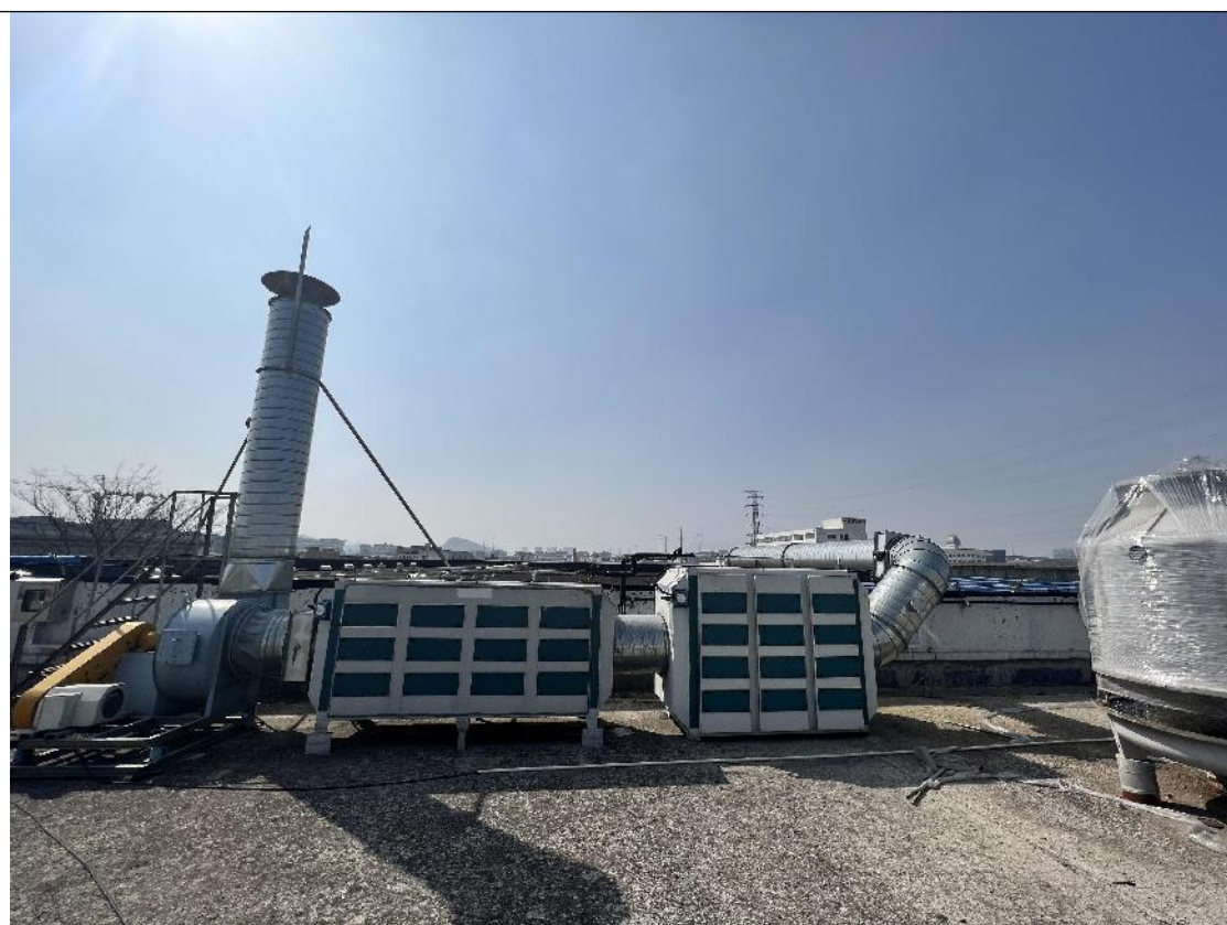
二级活性炭吸附装置、P1 排气筒
