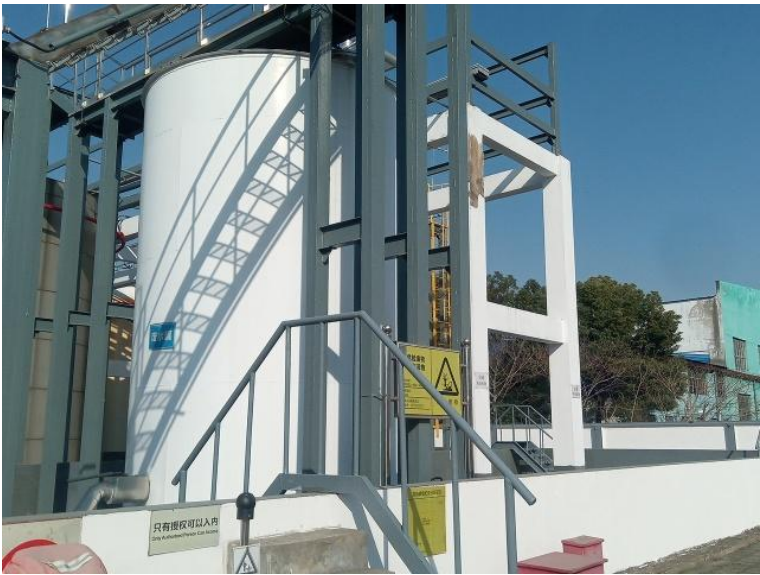
图 3.9-2 废水储罐图片
