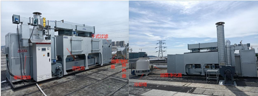
图 3-2 冷却塔换热器+油雾净化器+干式过滤箱+活性炭吸附脱附催化燃烧装置+排气筒 1#
