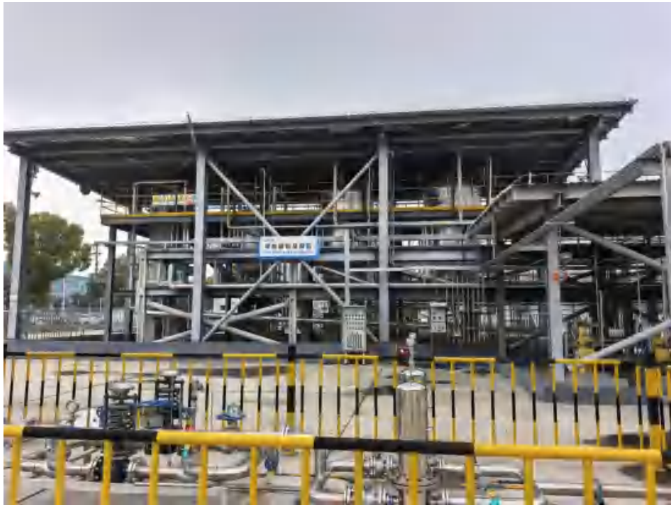
甲类罐区及泵区
