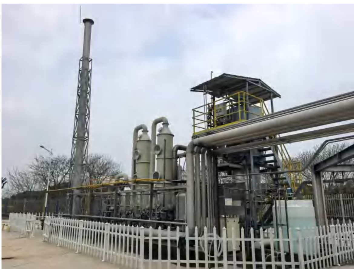
图 4.1-3 废气处理设施照片
