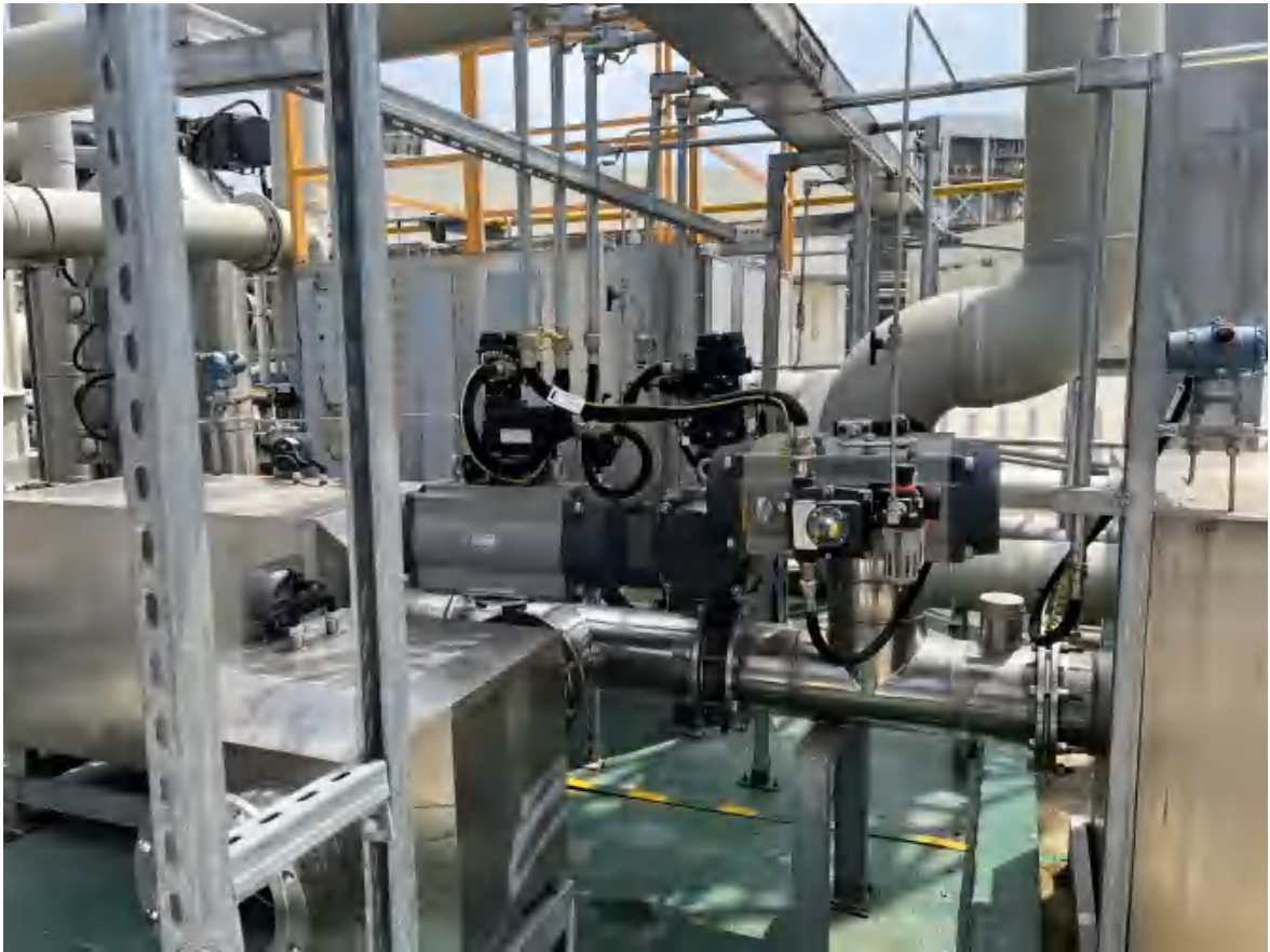
图 7.1-1 废气处理设施进口照片
