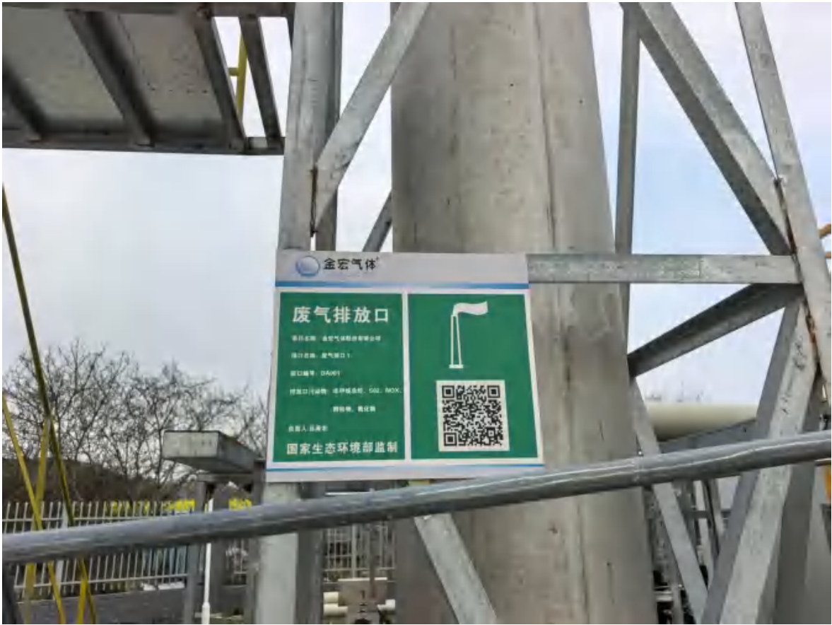
图 4.1-4 废气排气筒照片
