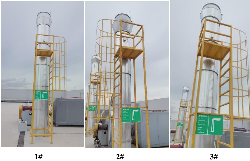
图3-2 废气处理设施照片
