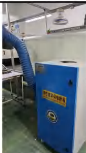
丝网印刷工序配套废气处理设施
