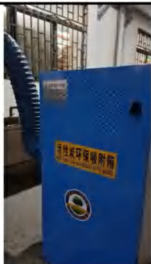
造粒工序配套废气处理设施
