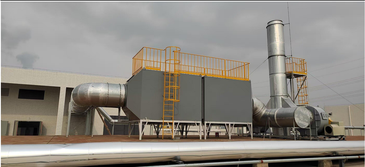
图 3-2 A8-1-1#废气排气筒
